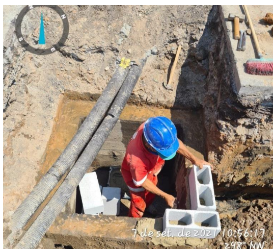
Figura 31 – Transformação em caixa de passagem em PV
