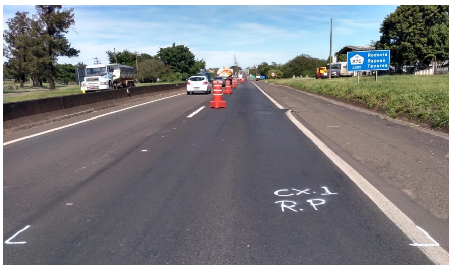
Figura 24: Delimitação do trecho com defeito (antes).
