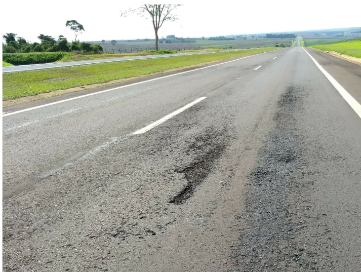
Figura 18: Trecho com defeito (antes).
