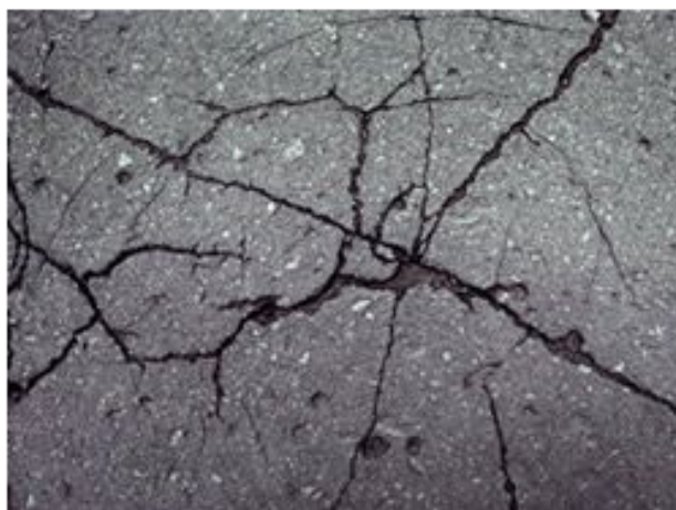
Figura 6: Fissuras e trincas.
