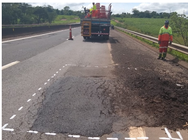
Figura 15 Trecho com defeito (antes).
