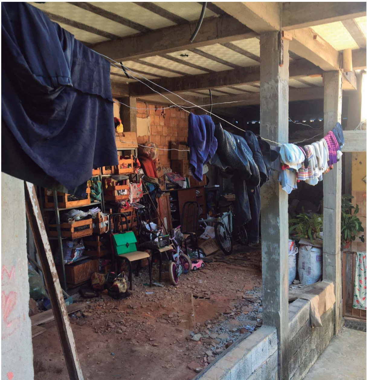
Figura 3 – Área da reforma do Quilombo Mattias após embargo que permanece inacabada
