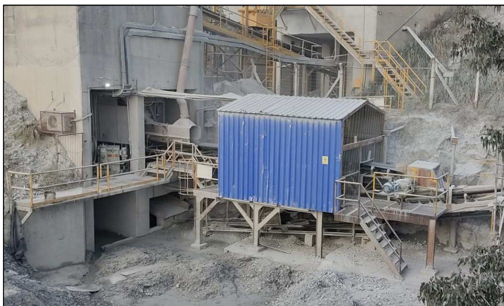
Figura 23. Vista externa da localização do PGNAA, dentro da contenção metálica azul (foto).
