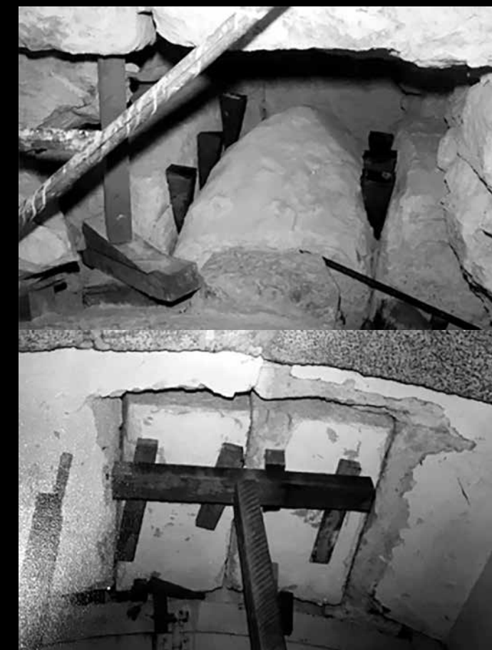
Figs. 72 e 73 – Registro do processo das obras de estabilização na padieira de cantaria em forma de arco abatido, da janela direita do coro, durante as obras de intervenção e restauro do frontispício da Matriz, promovidas pelo SPHAN entre 1983 e 1985 Fonte: Arquivo Eclesiástico da Paróquia Nossa Senhora do Pilar de São João del-Rei (AEPNSP-SJRD)
