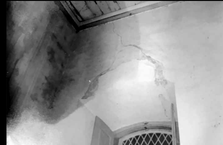
Fig. 71 – Registro das obras de restauro, promovidas pelo SPHAN entre 1983 e 1985, que objetivaram estabilizar um abatimento existente na torre do relógio, localizado no frontispício da Matriz e cujas consequências já se faziam sentir na janela do coro, tanto interna quanto externamente Fonte: Arquivo Eclesiástico da Paróquia Nossa Senhora do Pilar de São João del-Rei (AEPNSP-SJRD)
