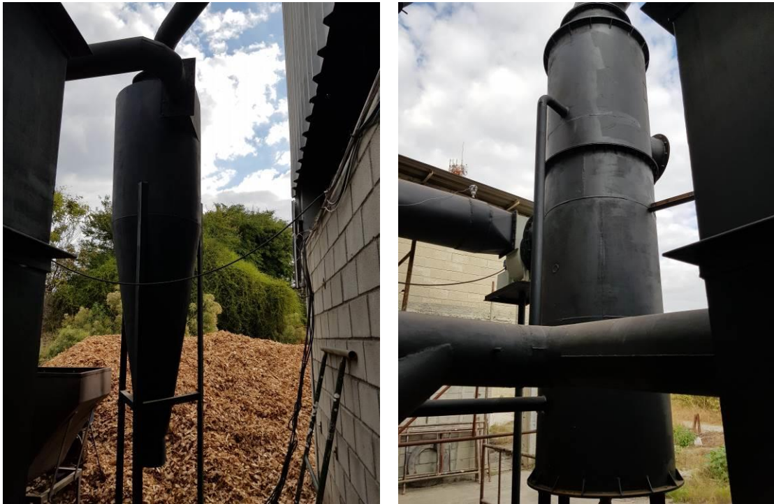
Figura 8 – Ciclone para retenção de sólidos e condensado (esquerda) e lavador por via úmida (direita)
