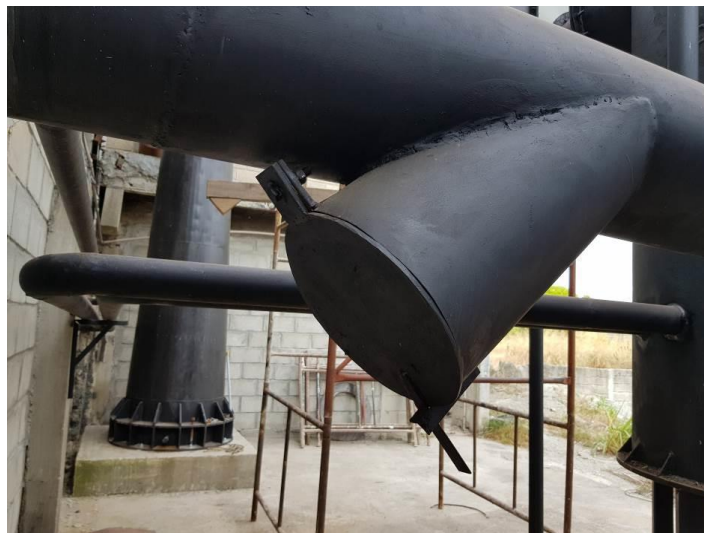
Figura 12 – Detalhe da tomada de ar fresco com damper
