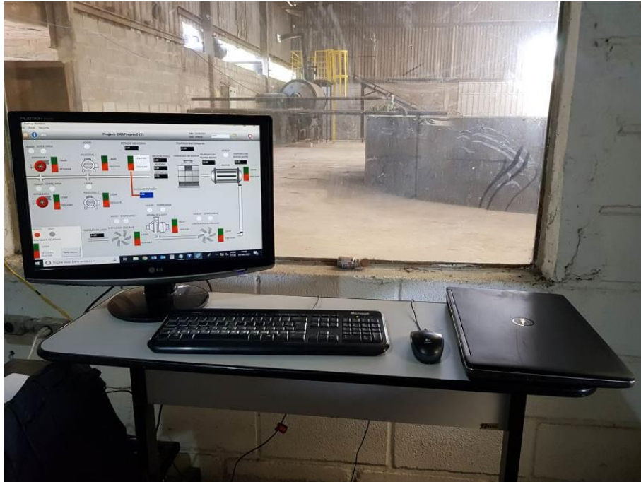
Figura 9 – Sala de controle da operação
