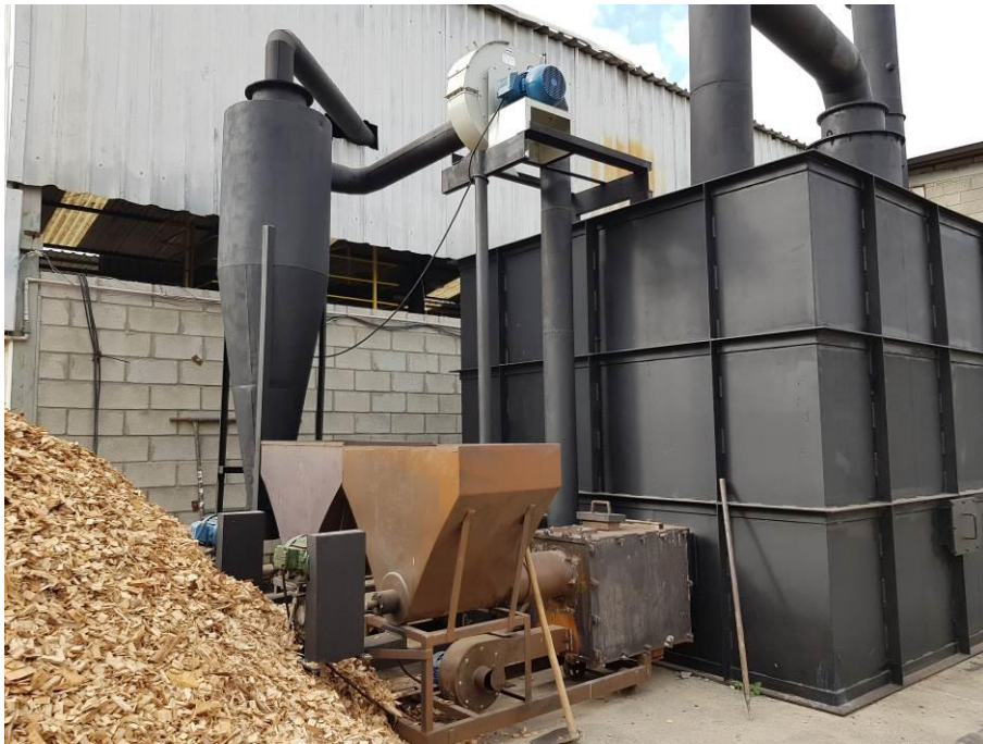
Figura 7 – Combustores para a queima do combustível e fornalha
