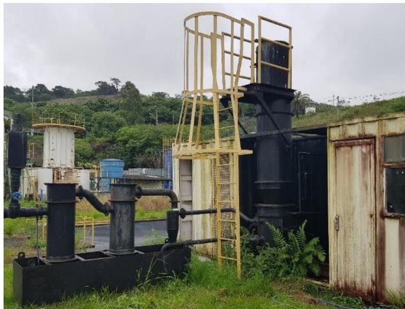
Figura 19 – Gaseificador e equipamentos auxiliares
