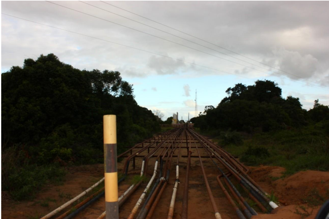
Figura 7: Dutos na Unidade de Processamento de Gás Natural de Lagoa Parda. Foto: Flávia Amboss Merçon Leonardo
