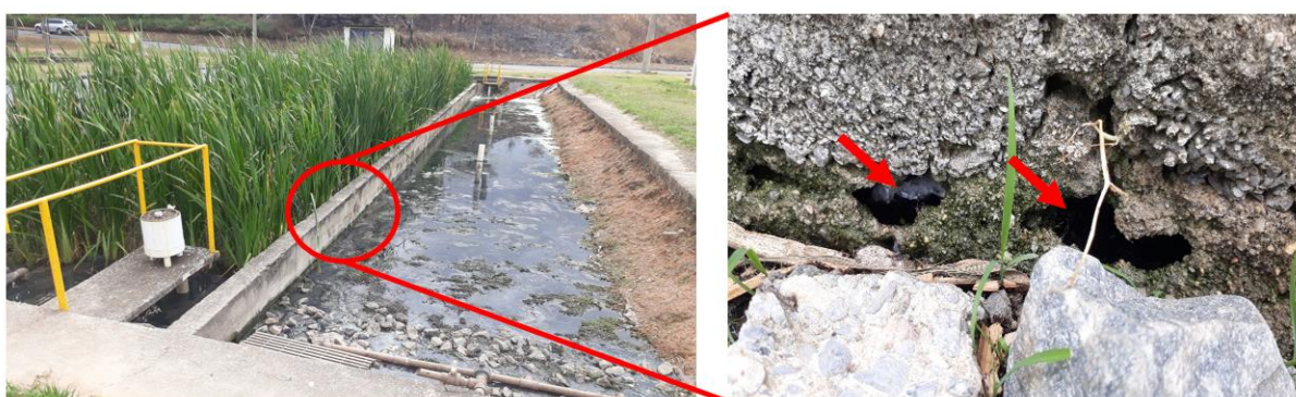
Figura 5-15: Buracos na parede de divisão entre a unidade plantada e não plantada, causado pelo desgaste do cimento ao longo do tempo e pela ação da água residuária.
