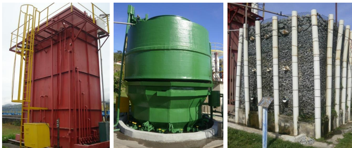
Figura 5-3: Reator UASB retangular (esquerda), reator UASB cilíndrico (centro) e filtro biológico percolador aberto (direita).
