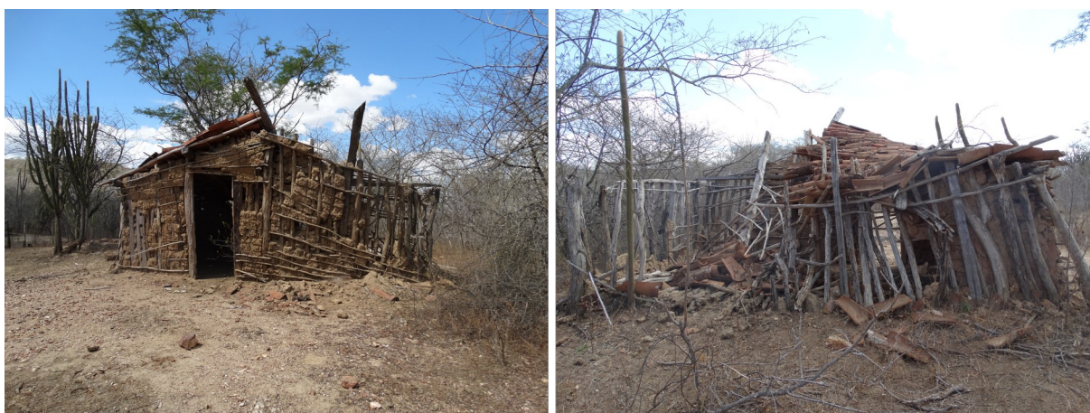
Figura 36 - Casa de taipa derrocada no alto da Serra do Piauí
