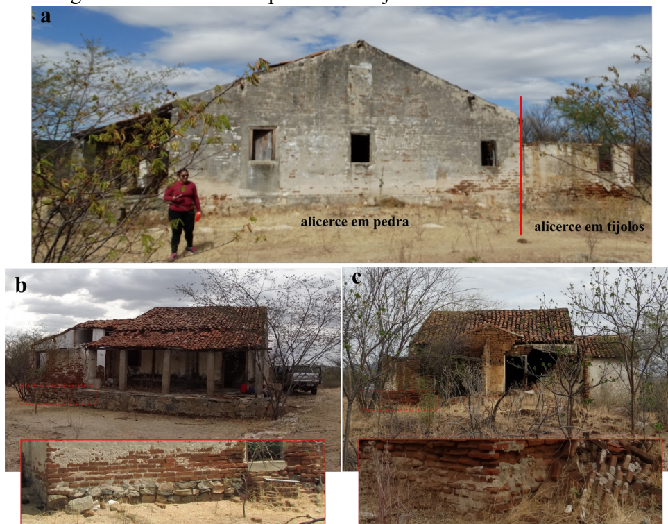
Figura 38 - Alicerce em pedra e em tijolos na casa do sítio Belém
