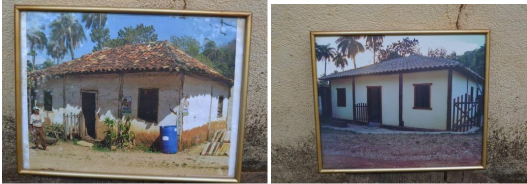
Figura 53 - Composição do antes depois da reforma da casa - Mato Grande de Cima
