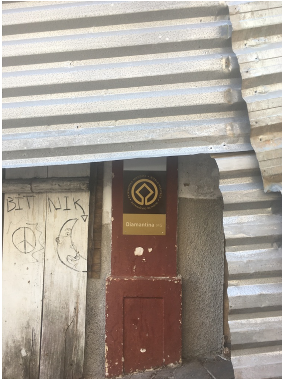
Figura 6: Placa em edificação deteriorada com tapumes metálicos, com indicação do reconhecimento de Diamantina enquanto Patrimônio Histórico da Humanidade. Fonte: Autora, jul/2022.
