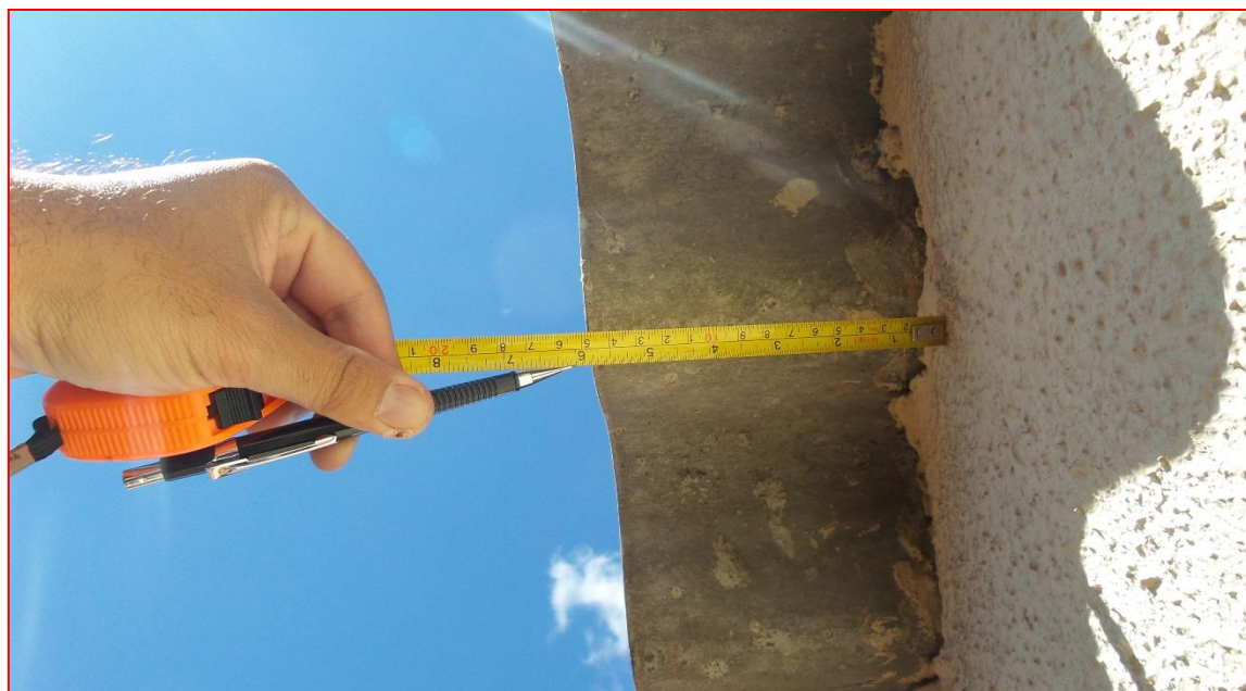
Figura 05: Telhado invadindo a divisa
