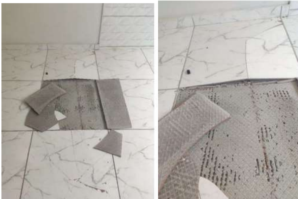
Figura 5-10: Revestimento destacado do imóvel.
