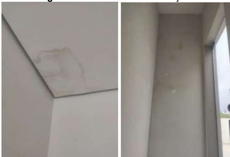
Figura 5-5: Evidências da infiltração.
