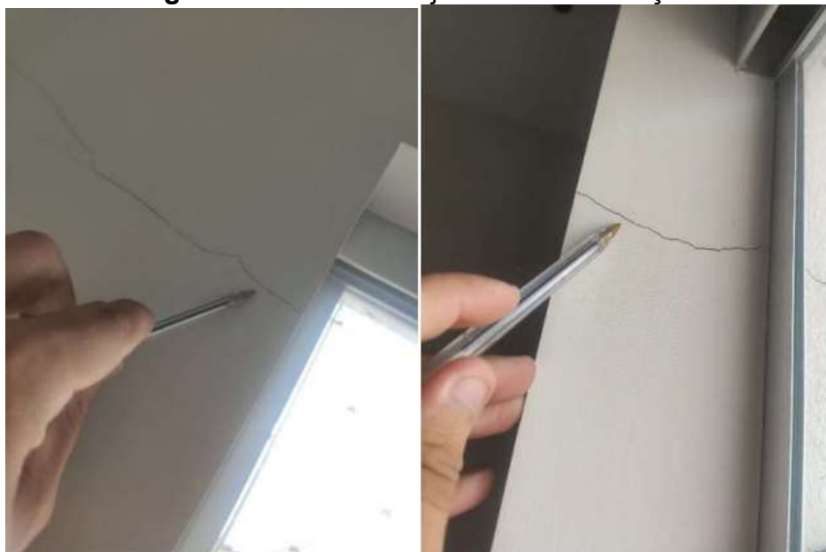
Figura 5-8: Trinca nas janelas da edificação.
