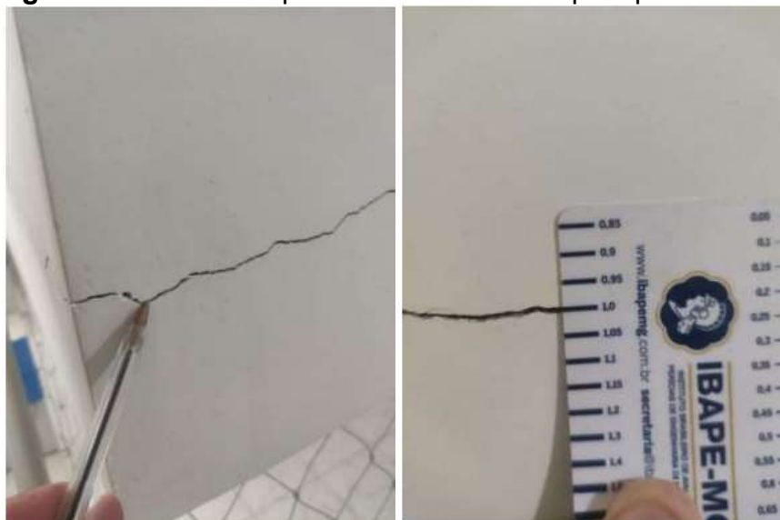
Figura 5-9: Trinca na parede escada onde apoia pilar cozinha.
