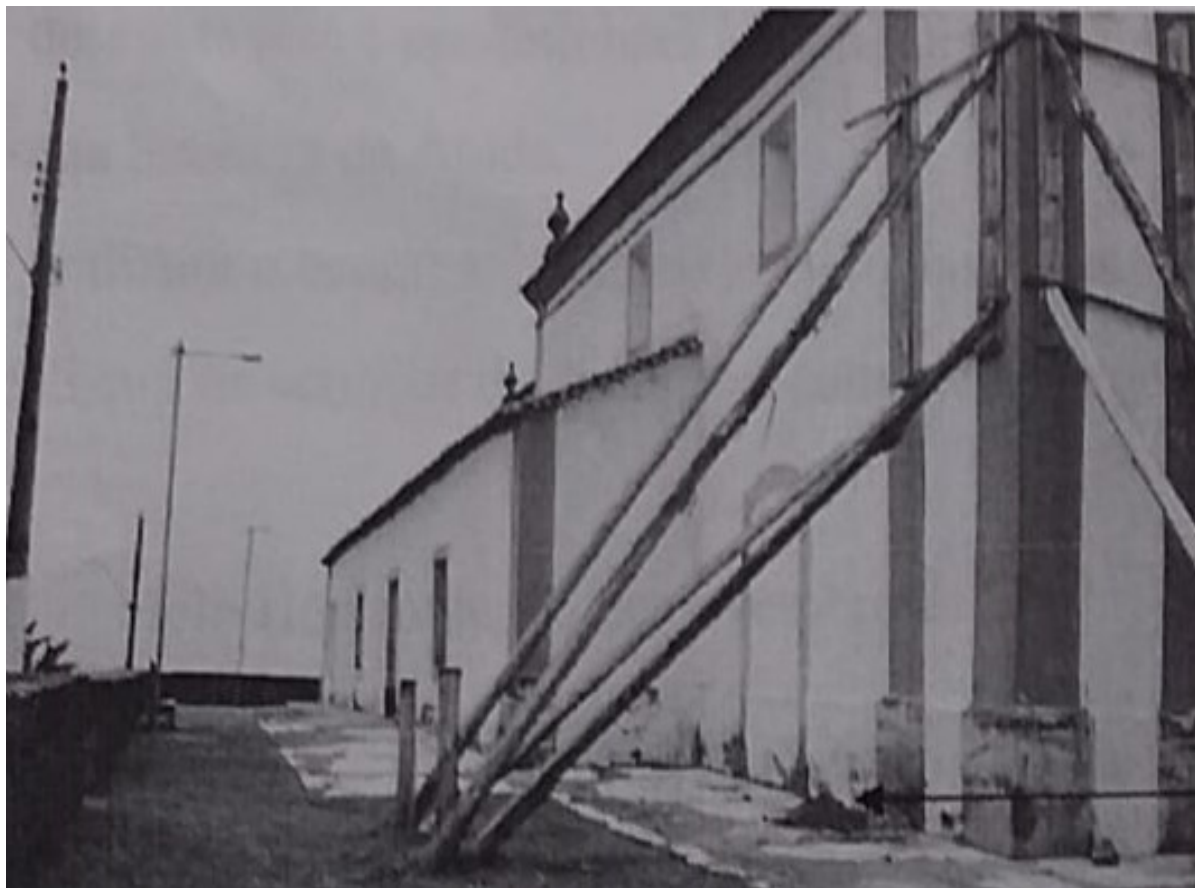
Figura 12 – Escoramento provisório de contenção emergencial do abatimento estrutural investigado
