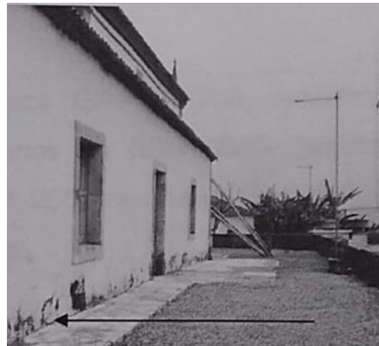
Figura 14 – Ausência de drenagem periférica
