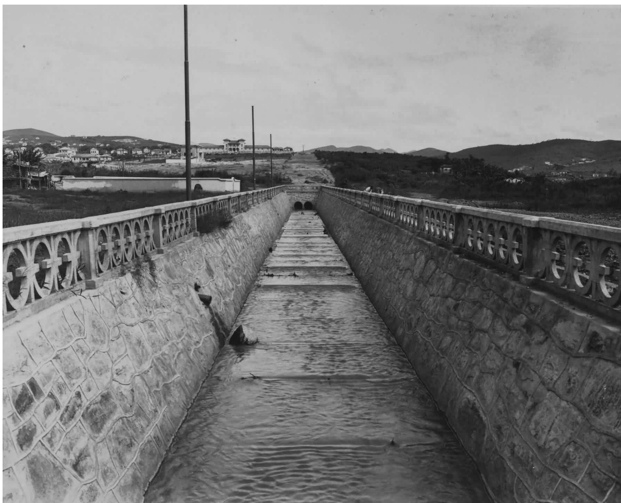
Figura 22 - Trecho da canalização do córrego do Leitão entre as ruas Gonçalves Dias e Alvarenga Peixoto em Belo Horizonte (MG).
