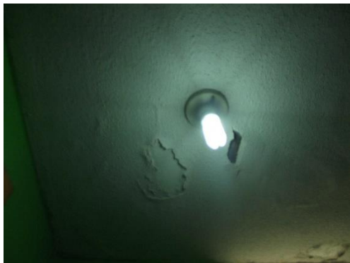
Fig. 12 Evidencias de infiltraciones de agua del departamento superior en la losa de techo del baño
