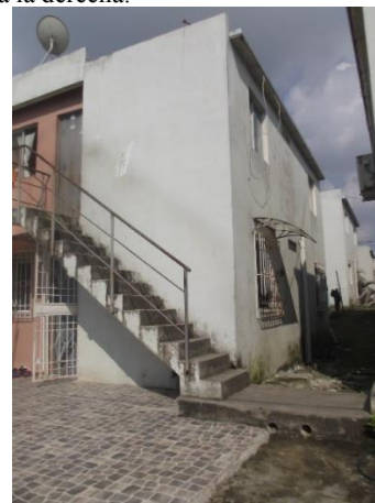
Fig. 03 – Fachada lateral derecha yéndose la cubierta de protección del balcón de atención a los clientes de la Tienda y las gradas de acceso a la vivienda superior.
