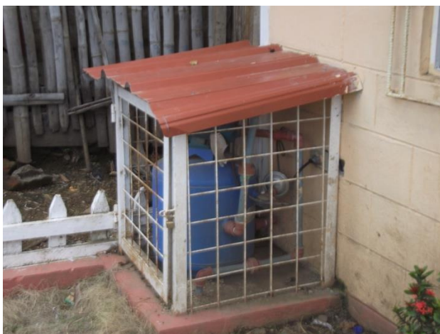
Fig. 15 – equipamiento instalado en las casas para filtración del agua.
