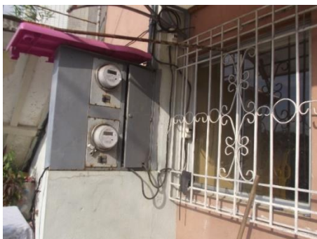
Fig. 14 Detalle de los medidores de energía de la casa inferior y de la superior
