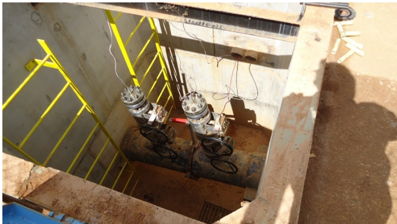
Figura 43 – Medidores de pressão instalados na tubulação
