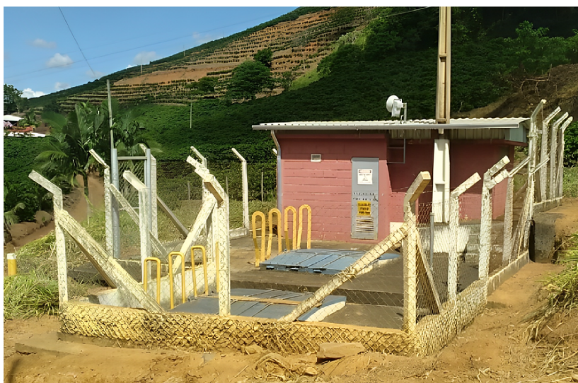
Figura 44 – Estação de monitoramento de pressão (PMS)
