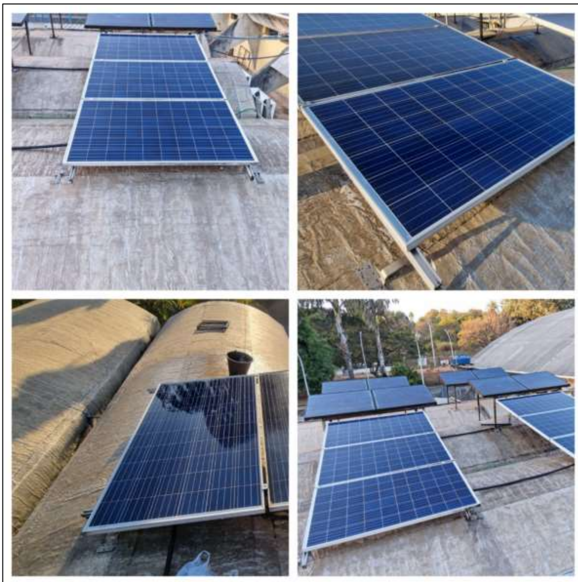
Figura 16 – Módulos fotovoltaicos após limpeza.
