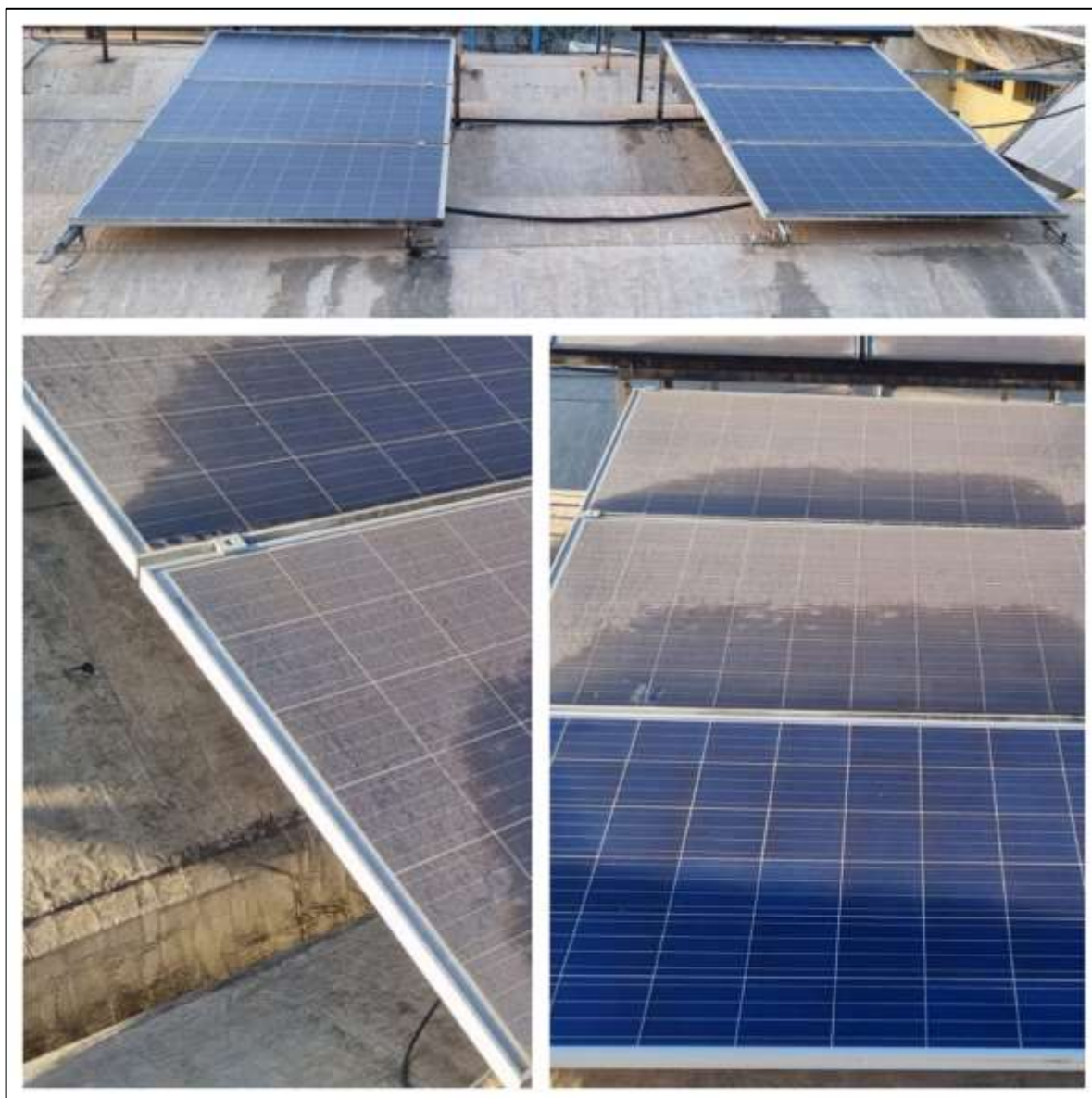
Figura 15 – Sujidade aparente nos módulos instalados no CPH.
