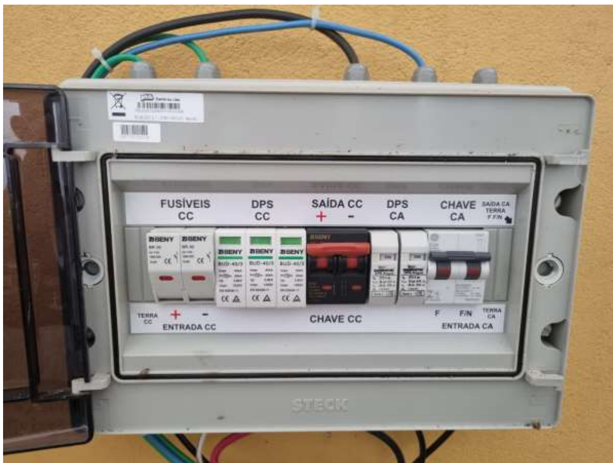
Figura 10 – Quadro de distribuição dos circuitos do sistema fotovoltaico.
