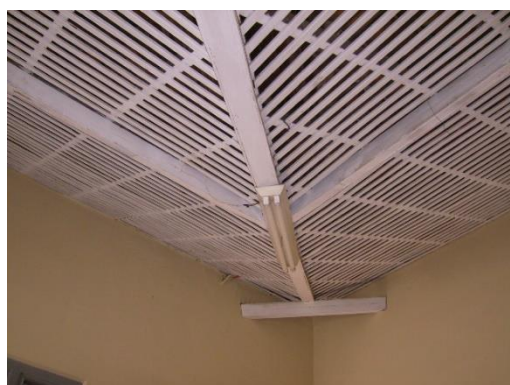
Forro ripado da cozinha da residência.
