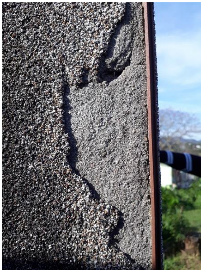
Figura 3 - Revestimento com pó de fulget desgastado com o tempo, tumulo do Cemitério Jardim da Saudade, Rua José Barin, Bairro Caturrita, Santa Maria – RS. Fonte: Acervo da acadêmica Bruna de Cássia C. Gonçalves.
