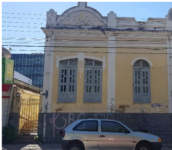
Figura 7.2 - Imagem frontal da edificação, com deformações.
