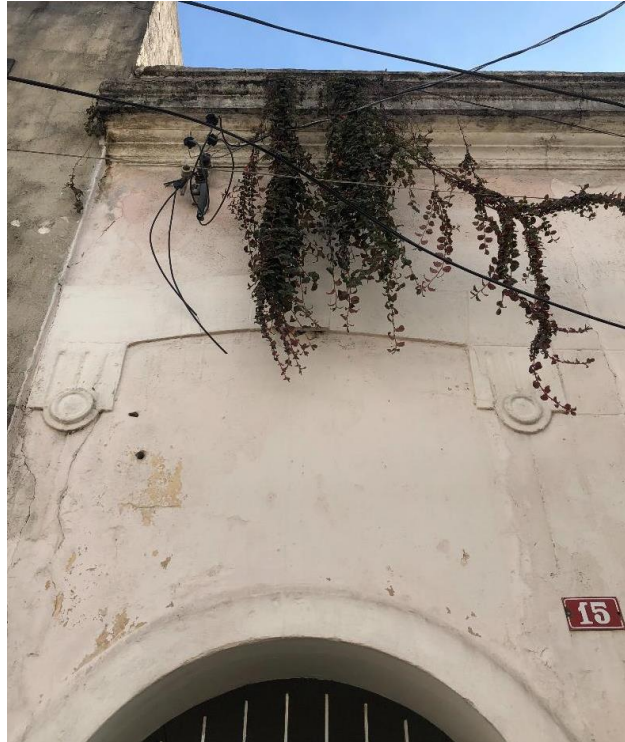
Figura 1 - Patologia (vegetação) identificada na casa n.15, Vila Economizadora – São Paulo-SP. Fonte: Autores, março de 2019.
