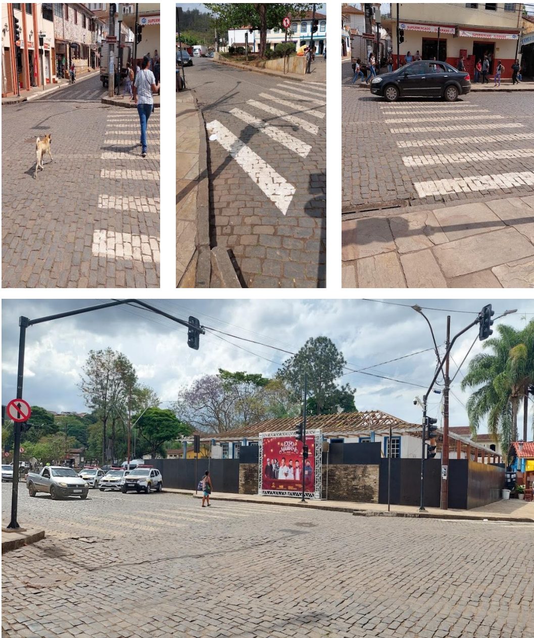
Figura 36- Travessia de pedestre sem rampa de acesso
