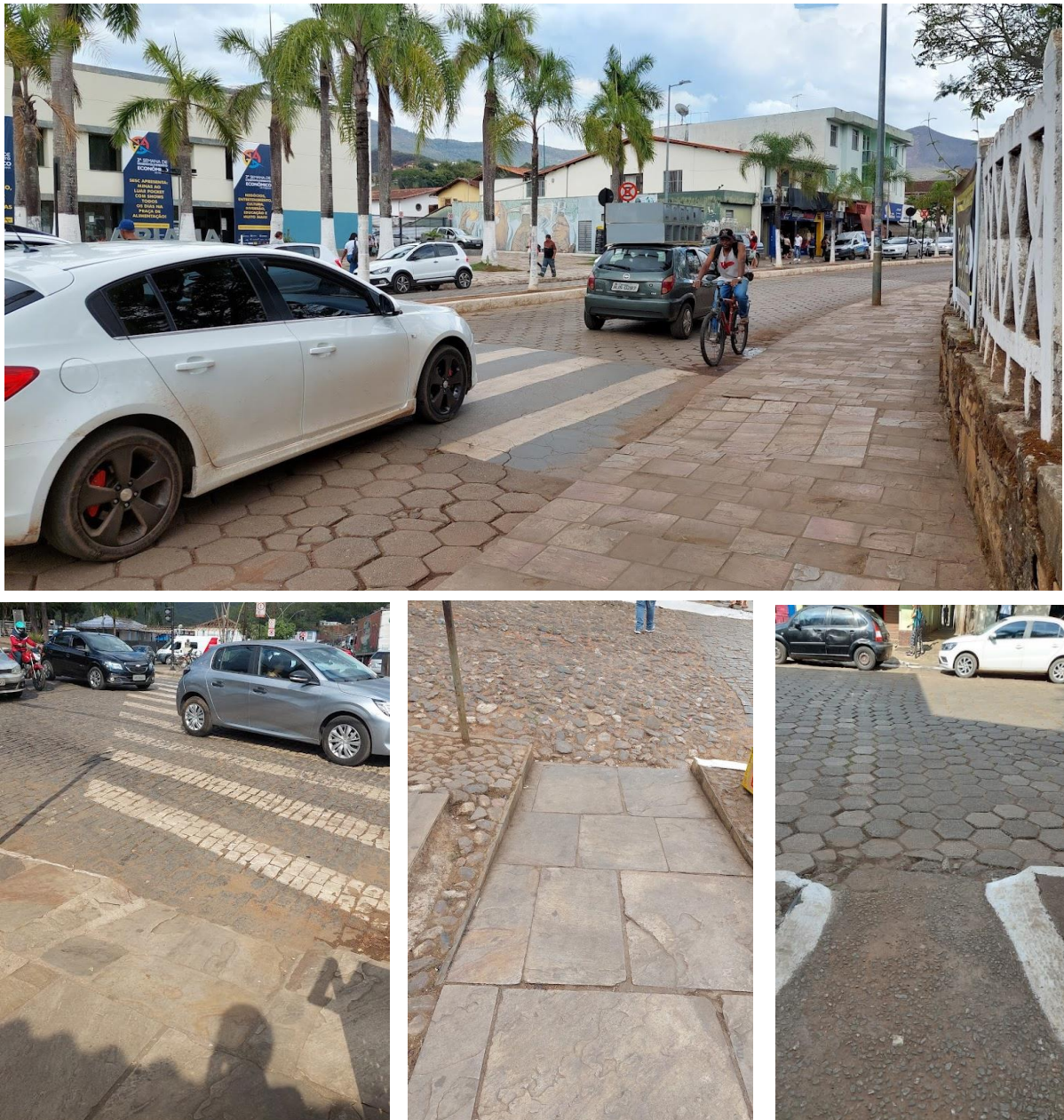
Figura 37- Rampas de acesso com inclinação acima do permitido
