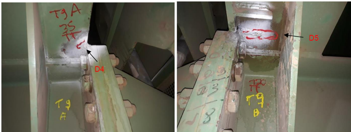
Figura 4.21: Descontinuidades D4 (esquerda) e D5 (direita) na solda próxima ao tirante 9.
