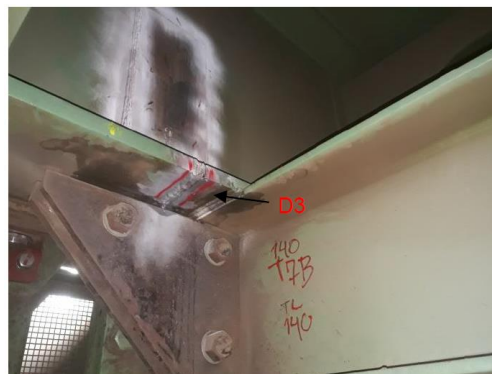
Figura 4.19: Descontinuidade D3 na solda próxima ao tirante 7.
