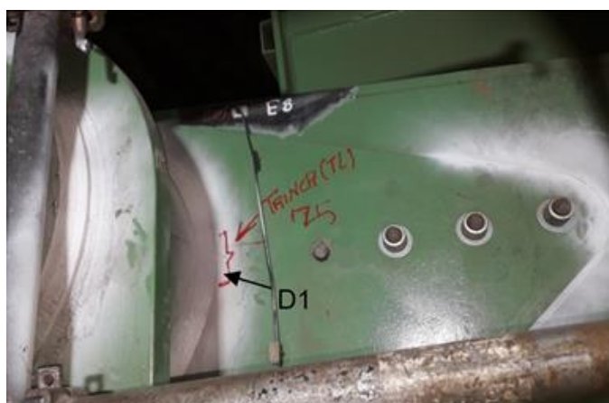
Figura 4.17: Descontinuidade D1 na solda das juntas tubulares lado direito.
