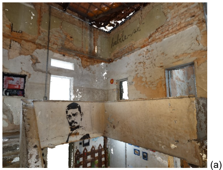
Figura 75 - Perspectivas internas do hall central do ECLE nas nuvens de pontos obtidas por (a) restituição fotogramétrica e (b) escaneamento com Lidar portátil, ilustrando a comparação entre os níveis de densidade dos pontos.
