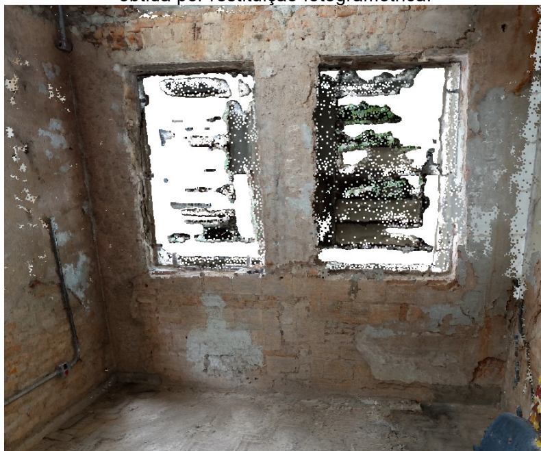
Figura 94 – Perspectiva de um dos ambientes do 2º pavimento do ECLE, na nuvem de pontos obtida por restituição fotogramétrica.
