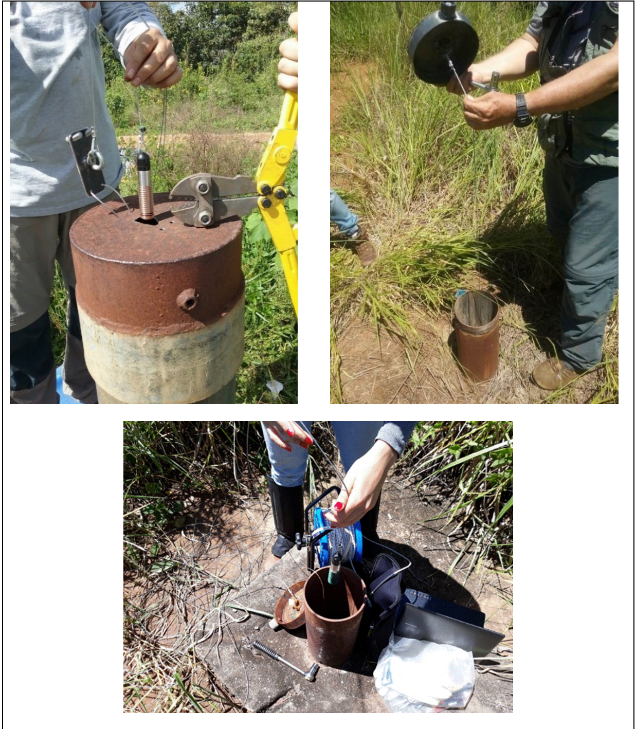
Figura 10: Instalação dos transdutores de pressão (loggers) em poços tubulares inoperantes. E medição de nível manualmente com o uso de medidor de nível analógico. (Fonte: Autor)
