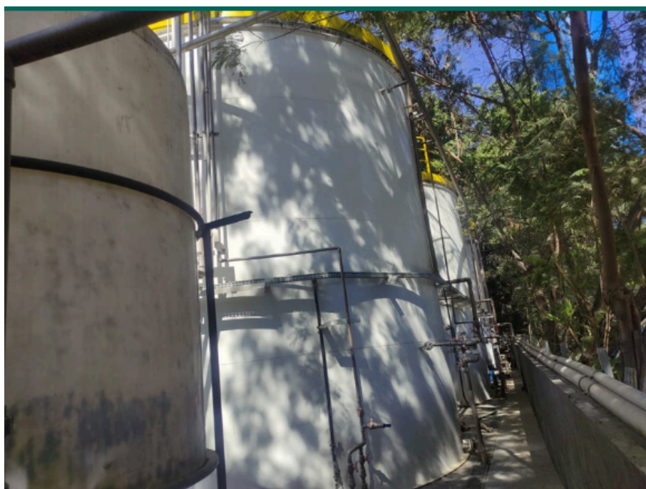
Figura 26 - ETE (Estação de Tratamento de Esgoto do Minas Shopping).
