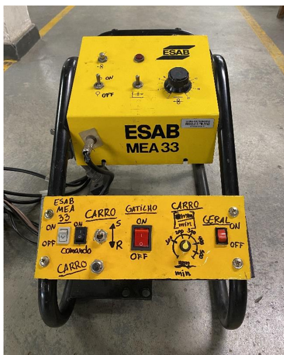
Figura 46: Painel de controle externo.
