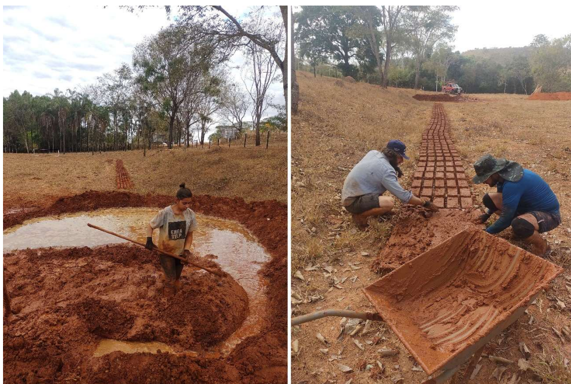
Figura 48 - À esquerda: Mariana na preparação da massa. À direita: corte de adobes por Max e Sérgio
