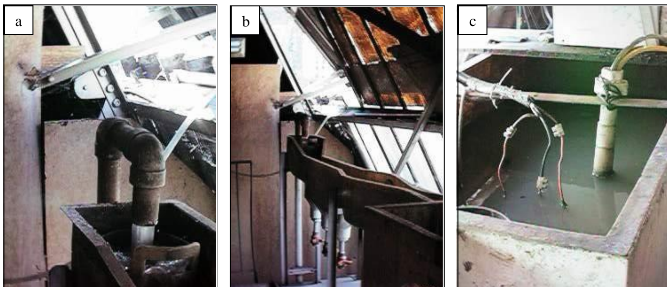
FIGURA 4.5 - Chegada do esgoto bruto e cesto (a), caixa de areia e calha parshall (b), caixa de distribuição e eletrodos de nível (c)
