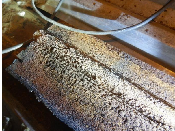
Figura 18 - Corrosão verificada em tubos de aço carbono de um economizador
