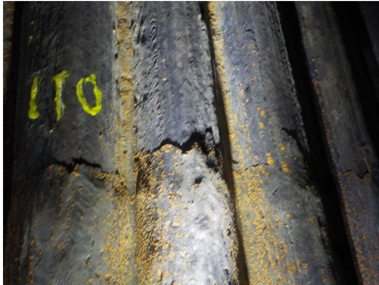
Figura 20 - Corrosão galvânica na zona de transição entre tubos protegidos com weld overlay com 25%Cr e 18%Cr.
