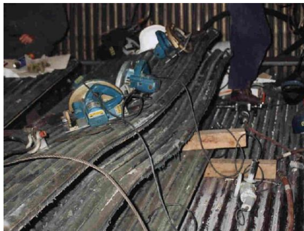
Figura 6 - Substituição de trechos do fundo de uma caldeira de recuperação deformados por queda de pedras de sulfato.
