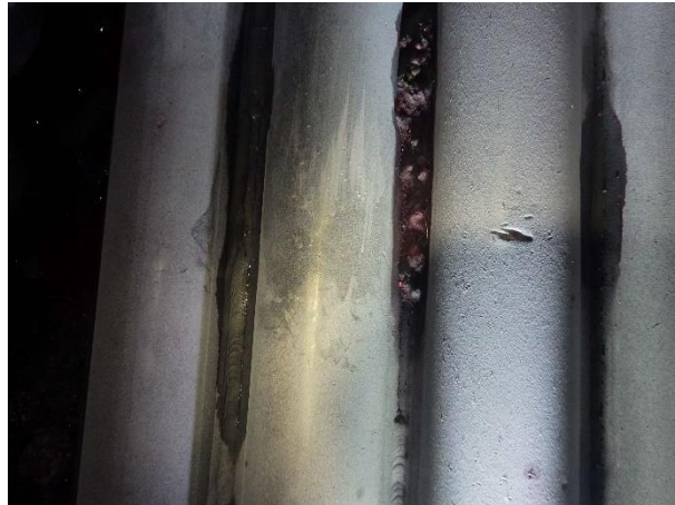
Figura 5 – Dano em tubo composto do fundo da caldeira decorrente de queda de material.
