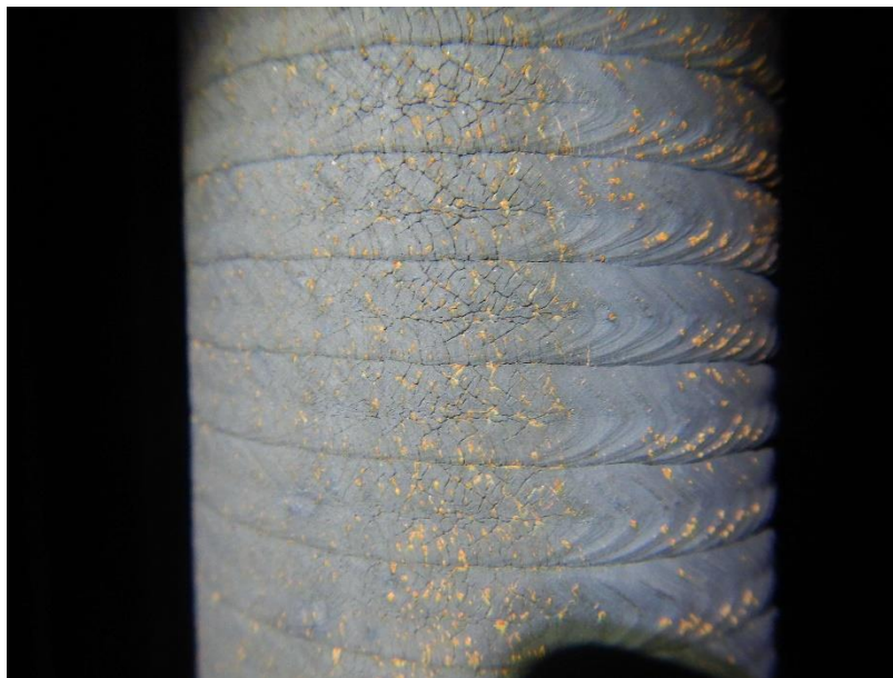
Figura 28 - Corrosão fadiga em tubo de painel de superaquecedor quaternário em SA 213 T22 com weld overlay em 309L por ação do soprador de fuligem.
