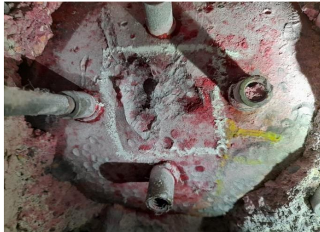
Figura 35 - Exemplo de dano mecânico por ação de martetele pneumático em coletor de parede d'água de uma caldeira de biomassa.
