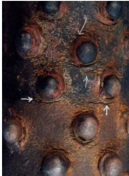
Figura 27 - Trincas de fadiga térmica junto aos tubos pinados da fornalha.
