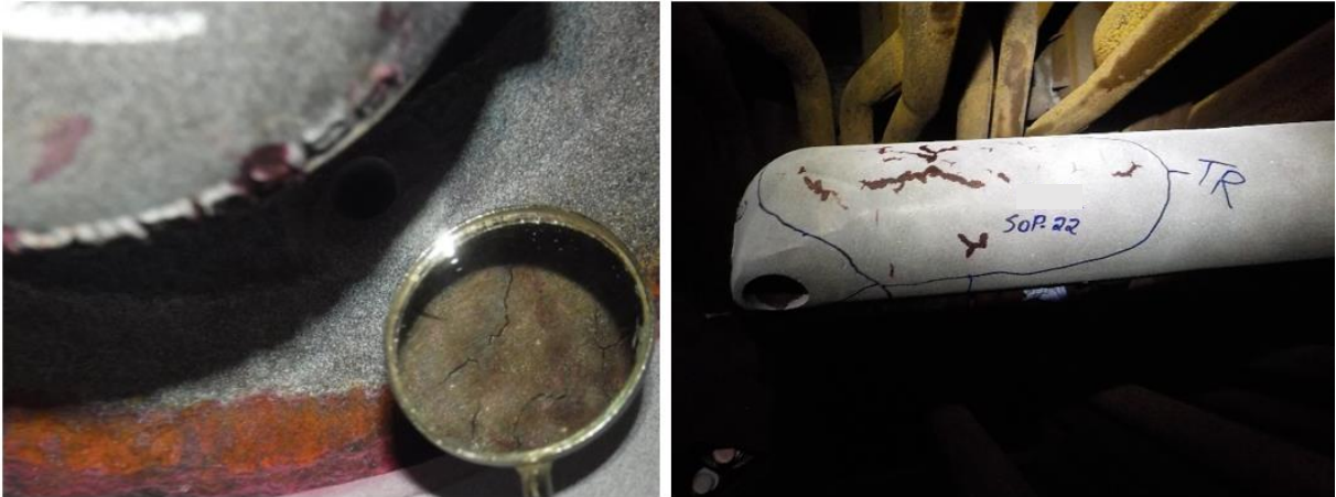
Figura 26 - Trincas de fadiga térmica em lanças de sopradores de fuligem reveladas pelo ensaio de líquido penetrante.
