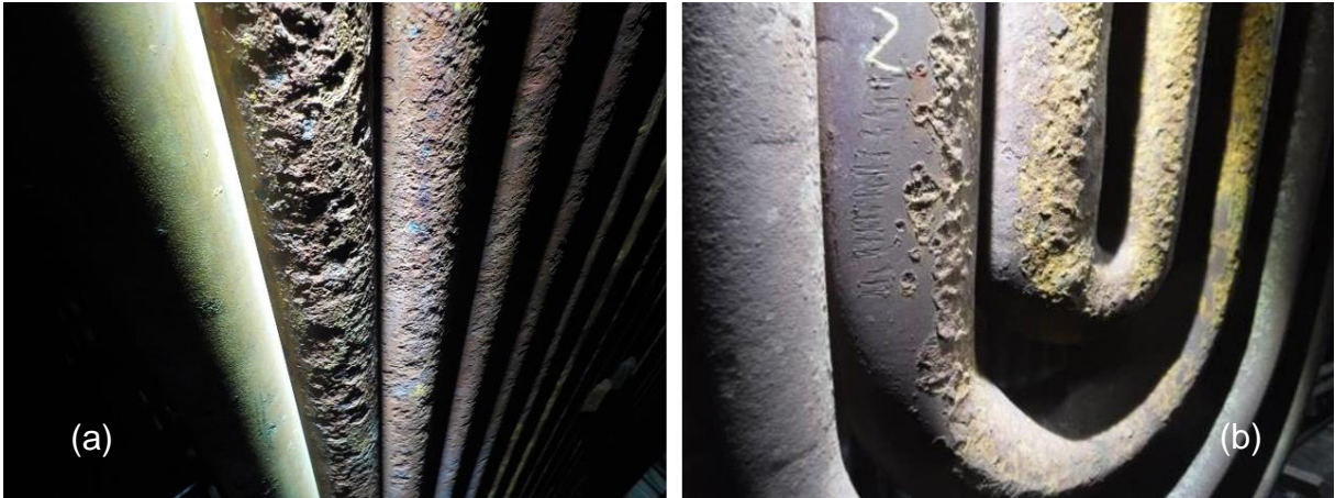
Figura 15 - Corrosão observada em um superaquecedor de caldeira de recuperação após 15 anos de operação (a) região de ação do soprador de fuligem (b) curvas inferiores.
