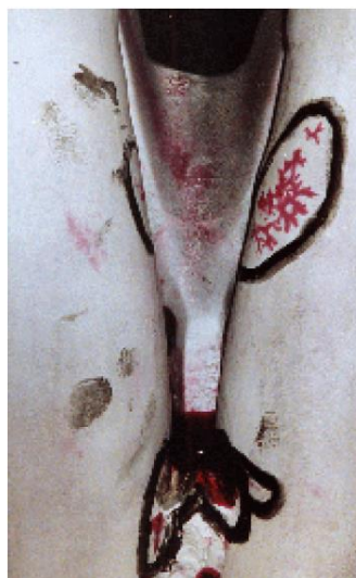
Figura 21 - Trincas de corrosão sob tensão cáustica em tubo de abertura de ar primário com revestimento em 304L reveladas pelo ensaio de líquido penetrante.
