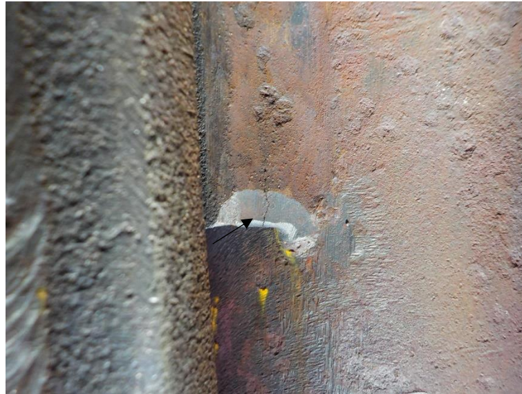
Figura 23 - Trinca de fadiga térmica em clipe de união dos tubos de um painel de superaquecedor.
