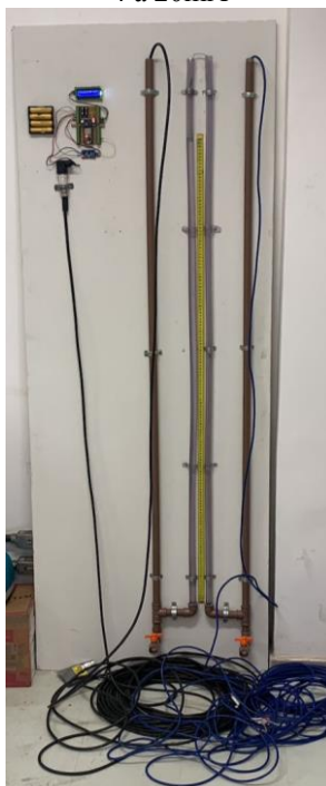
Figura 105 – Gabarito montado para realização do teste de leitura de um sensor de pressão que varia corrente de 4 a 20mA
