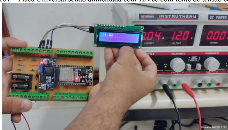
Figura 101 – Placa Universal sendo alimentada com 12Vcc com fonte de tensão controlada
