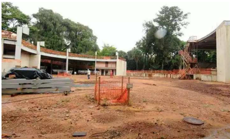
Figura 73: Reportagem sobre problemas técnicos e financeiros nas obras do “Espaço Multiuso”
