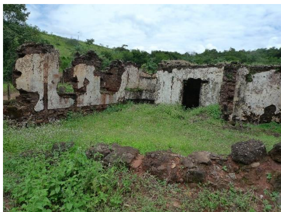
Figura 72: Ruínas de Gongo Soco sem manutenção adequada.
