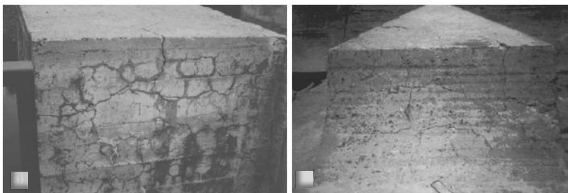
Figura 14 - Formação de fases expansivas (gipsita e etringita tardia) no concreto de uma barragem. A figura da esquerda é a barragem Graus e a da direita é a Tabescán.
