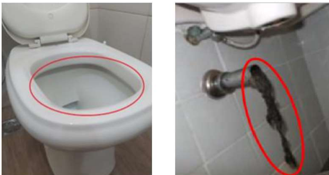
Figura 44 – Exemplos de entupimento de bacia sanitária e lavatório por objetos no sistema de esgotamento
