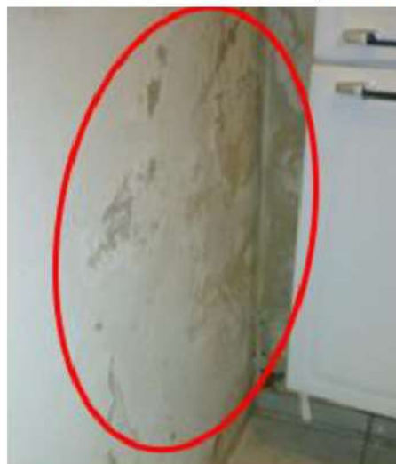
C. Manchas de bolor na parede
