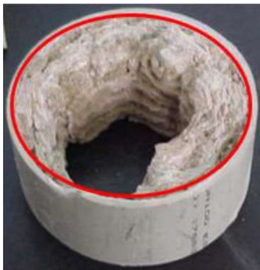
Figura 45 – Exemplo de entupimento por acúmulo de incrustações na tubulação de esgoto
