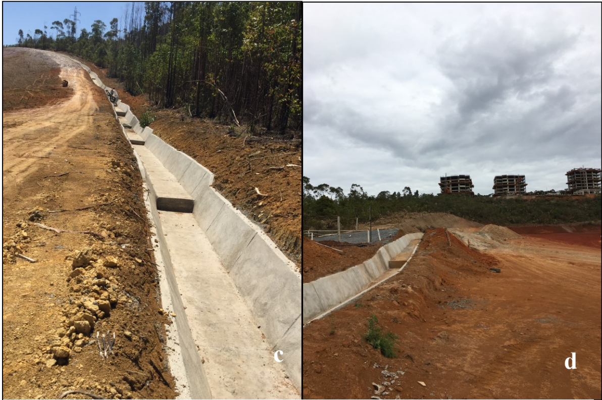
Figura 15 - Fotografias de canaletas do empreendimento A.
