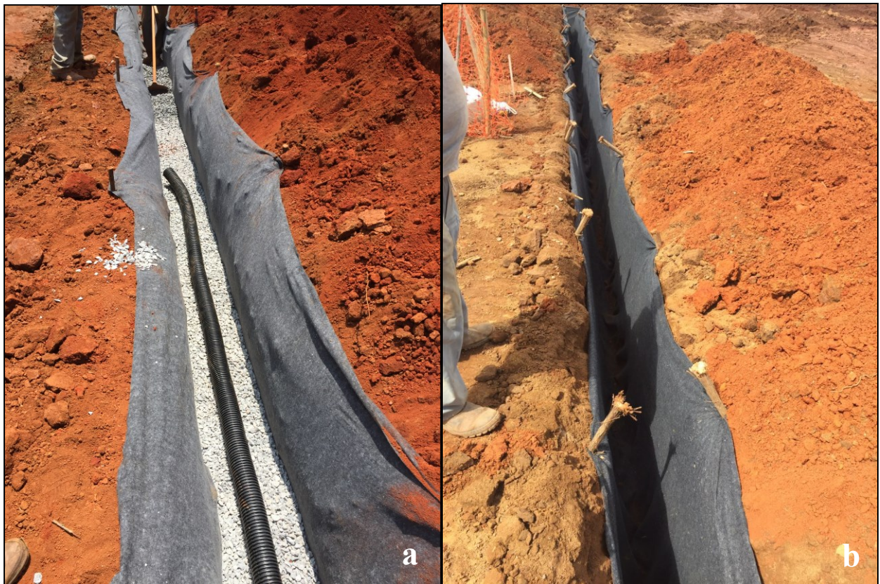
Figura 17 - Fotografias dos drenos tipo kanonet do empreendimento A.
