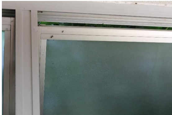
Figura 15. Presença de insetos na janela da sala de maturação
