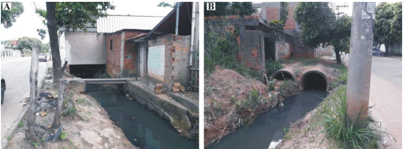
Figura 8. Aspecto do leito do Rio São Jacinto. Note as passarelas rudimentares de madeira que ligam a rua às residências e a casa construída sobre o canal (A), como também a canalização precária, parcialmente entulhada por sedimentos e lixo (B).
