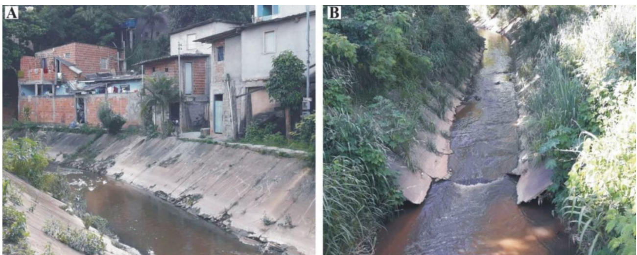
Figura 9. Aspectos do setor canalizado do Rio Santo Antônio em Teófilo Otoni. Em A se verifica a proximidade entre as residências e o canal e, em B, o estágio degradado da intervenção de natureza estrutural junto à calha fluvial.
