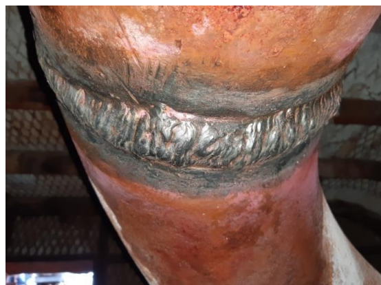
Figura 9 - Aspecto visual da junta soldada JS2.
