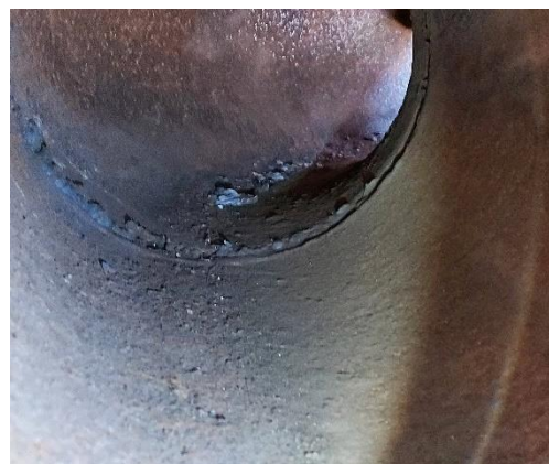
Figura 13 - Aspecto das descontinuidades encontradas na tubulação.
