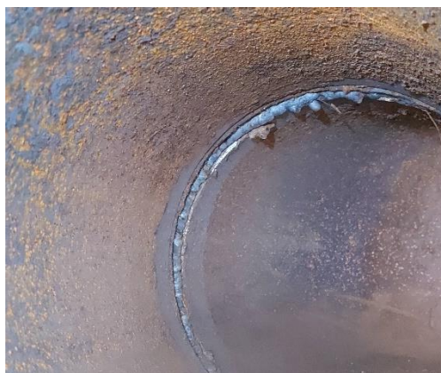
Figura 12 - Aspecto das descontinuidades encontradas na tubulação.
