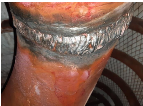
Figura 8 - Aspecto visual da junta soldada JS1.
