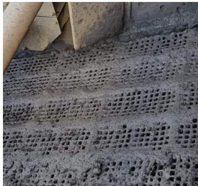
Figura 3 - Incrustação de material crítico nas telas do 1º deck . (Arquivo pessoal do autor, 2023)
