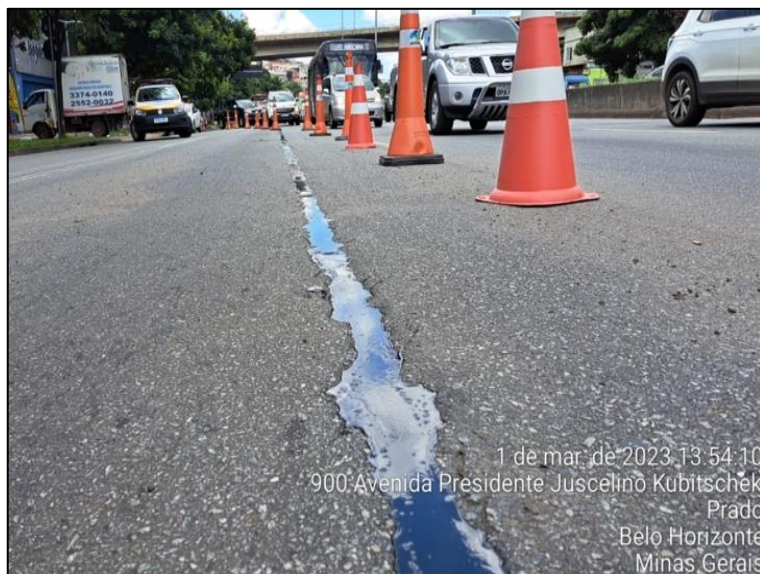
Figura 54: Selagem de trinca longitudinal
