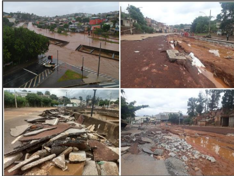
Figura 17: Fotos de Inundações e Estragos na Avenida Teresa Cristina em Belo Horizonte
