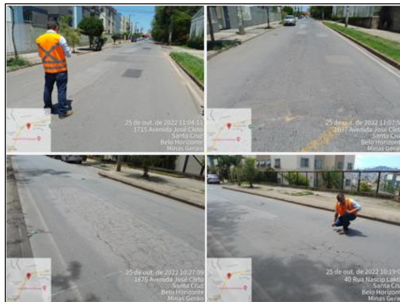
Figura 36: Vistorias de campo para avaliação dos métodos do IGG, PCI e ICP-SUDECAP
