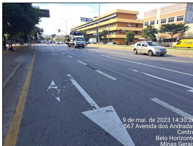
Figura 61: Condição funcional do pavimento da Avenida dos Andradas em 2023
