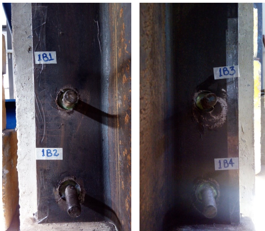
Figura 3.16 – Posicionamento do perfil com os blocos de concreto (A e B), mantendo os chumbadores centralizados no furo alargado.
