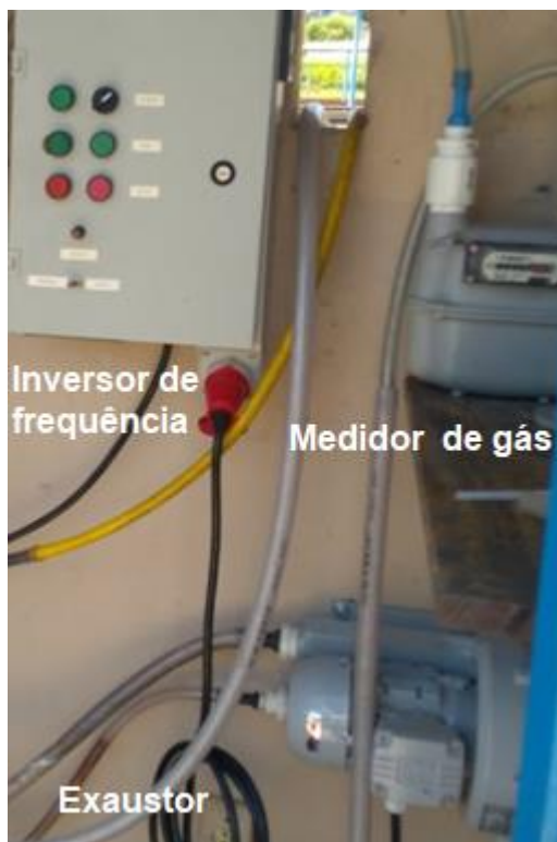
Figura 4.3 - Sistema de exaustão CD em escada de demonstração com exaustor e inversor de frequência
