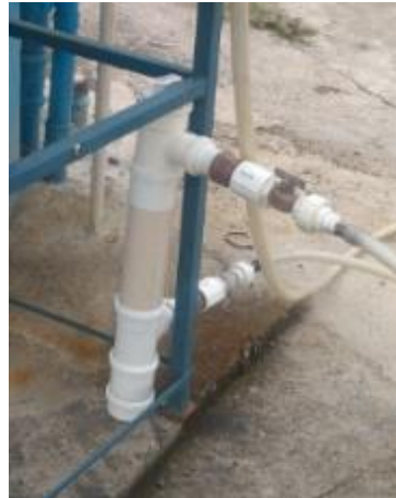
Figura 4.4 - Sistema para remoção de umidade
