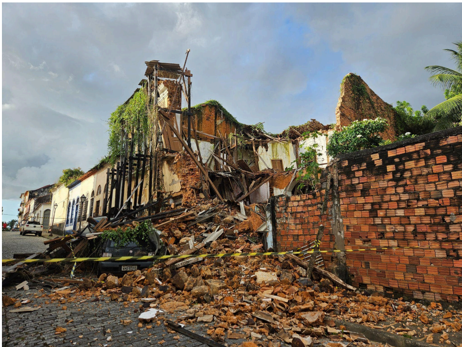
Figura 68 - Escombros de casarão desabado na Rua do Giz.
