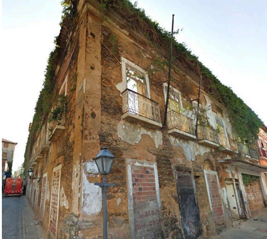
Figura 40 - Sobrado da rua da Palma nº 195/205 em estado de arruinamento, em 2012.
