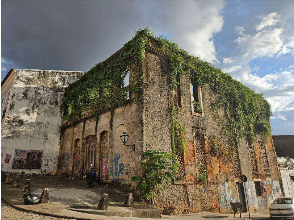
Figura 67 - Edificação em estado de arruinamento na Rua da Estrela.
