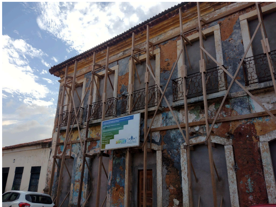
Figura 62 - Imóvel em ruína com escoramento emergencial realizado pelo IPHAN, na Rua da Palma.
