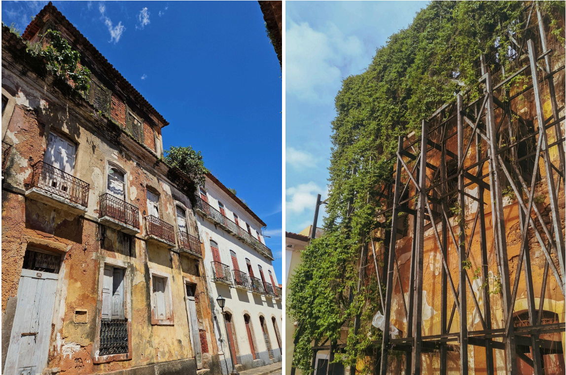
Figuras 63 e 64 - Edificações em estado de arruinamento na rua Quatorze de Julho e na Rua do Giz, respectivamente.
