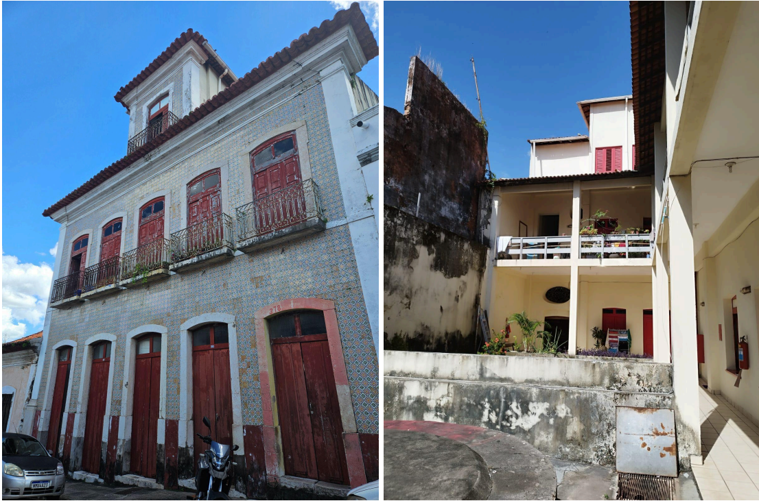
Figuras 33 e 34 - Edifício da Rua Afonso Pena, nº 378, fachada e pátio interno
