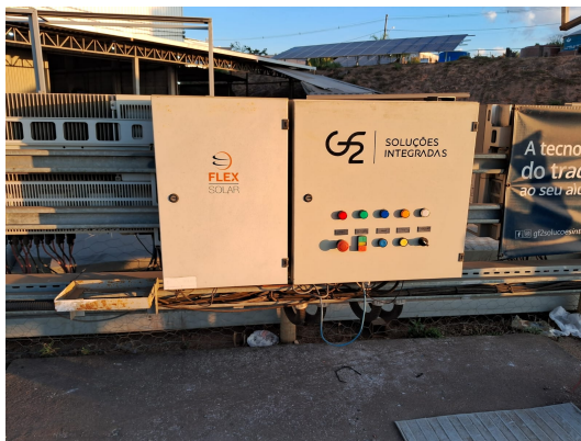
(a) Painel da usina piloto: porta fechada.
