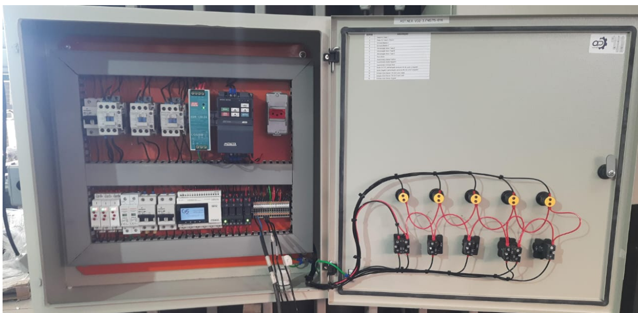
Figura 3.1 – Painel do seguidor solar original com CLP.
