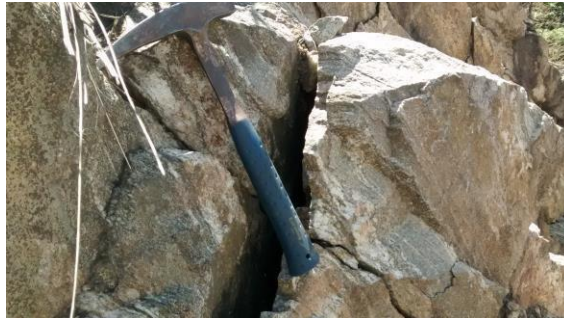
Figura 14 – Formação de blocos, talude de Pará de Minas.
