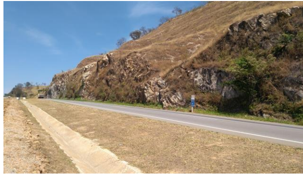
Figura 2. Talude de Pará de Minas.
