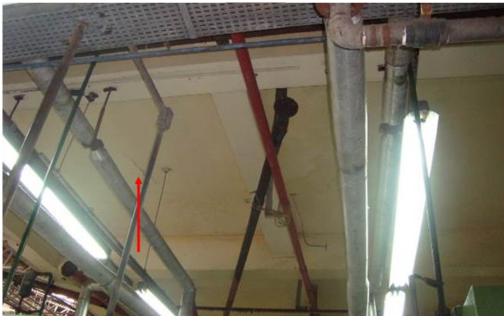
Figura 9- Outra vista da parte inferior da laje de piso da “cozinha” – presença de danos no cobrimento do concreto.
