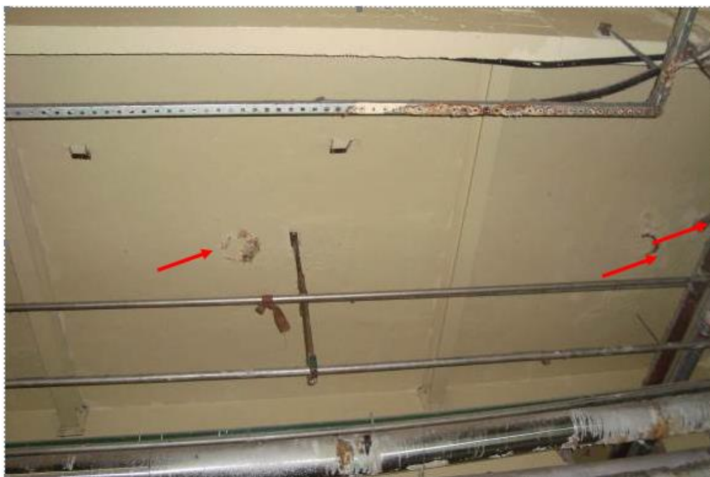
Figura 10- Vista de danos diversos na laje abaixo da “cozinha”.
