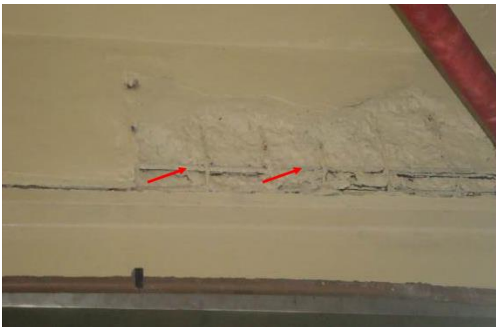
Figura 13- Vista de região com ferragem exposta submetida a pintura recente.
