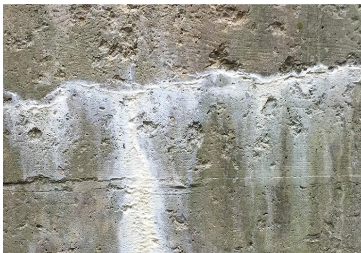
Figura 3- Eflorescência no concreto armado.
