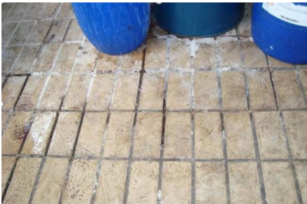
Figura 15- Vista aproximada do piso – rejunte em péssimas condições.
