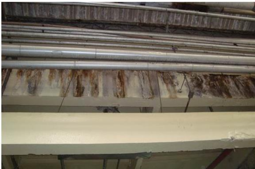
Figura 11- Vista de danos generalizados em viga junto a laje abaixo da “cozinha”.
