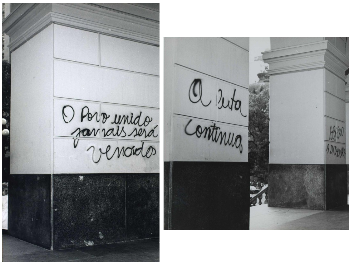
FOTOGRAFIA 10 – [Pichações nos pilares da fachada frontal do edifício da Biblioteca Nacional, Rio de Janeiro, 19--].
