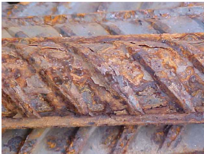
Figura 2 - Vergalhão de aço carbono com corrosão
