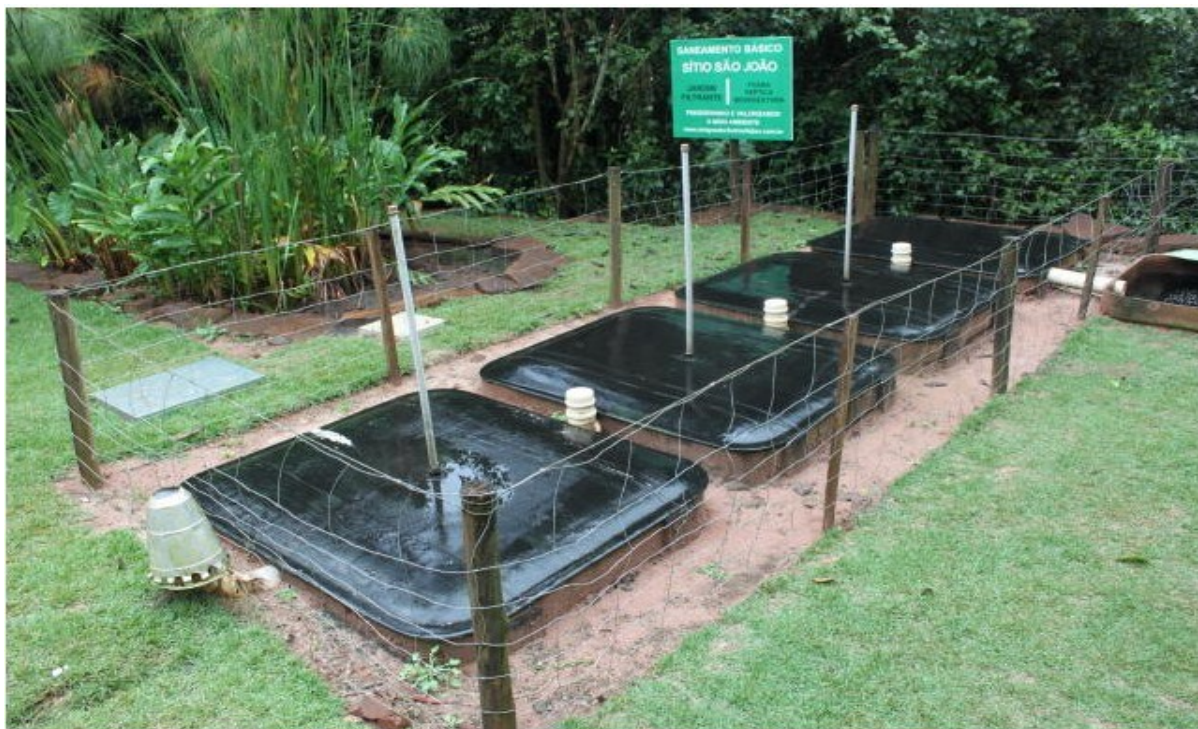
Figura 4. Sistema de fossa séptica Biodigestora
