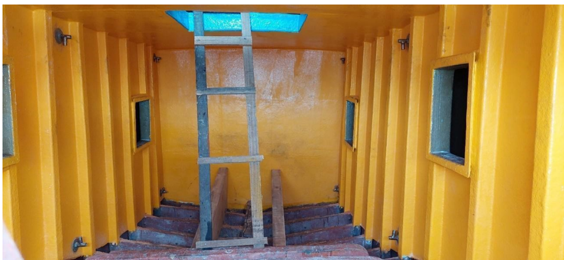
Figura 91. Sala do motor com os tanques de água e de óleo nas laterais.
