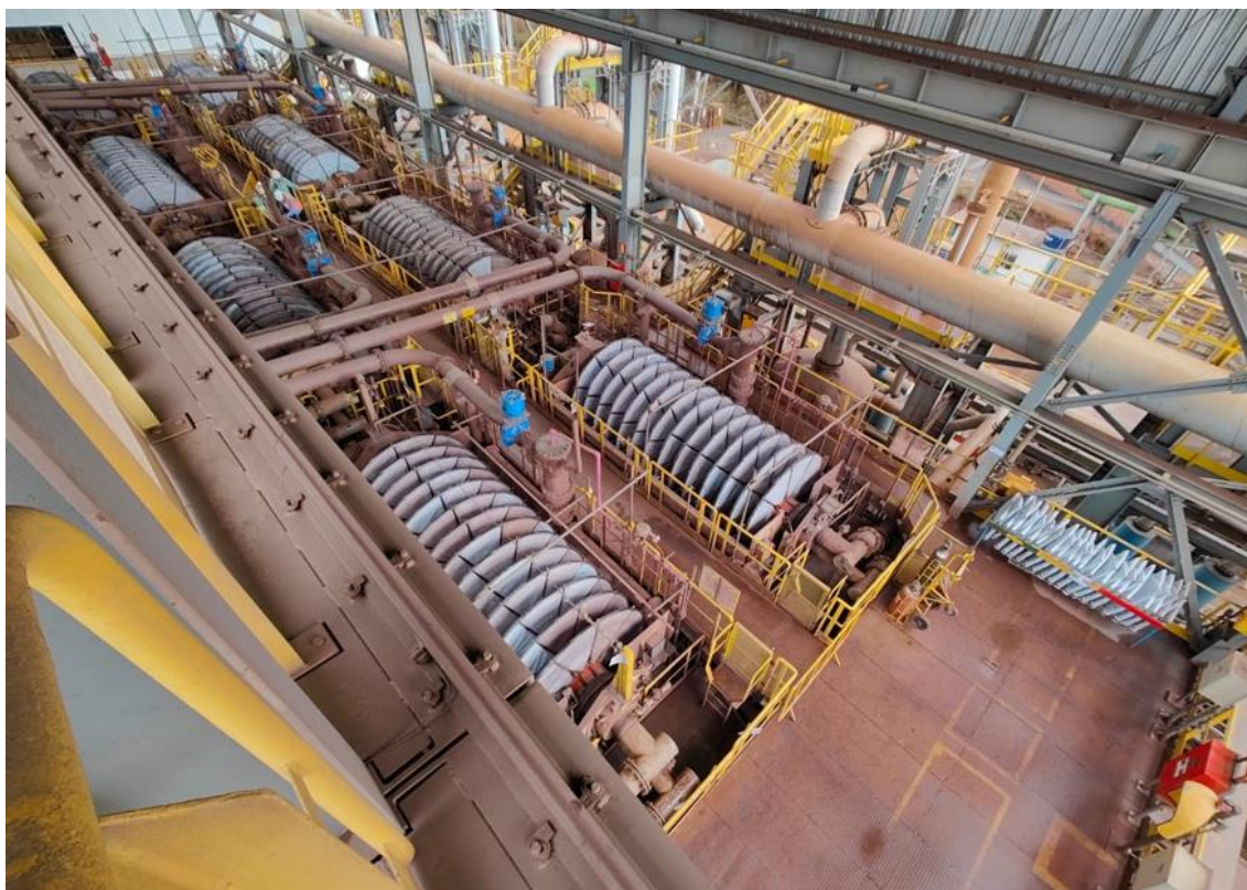
Figura 6: Prédio da filtração de rejeito composta de 8 filtros.
